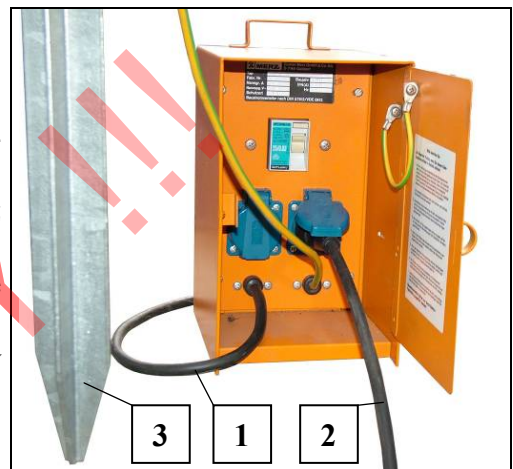
Rys. 17 Mała rozdzielnica budowlana
