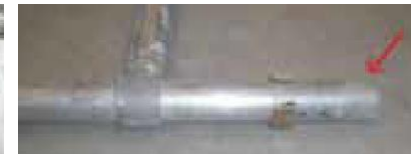
Brak okucia na dole poprzecznej ramy poręczy
